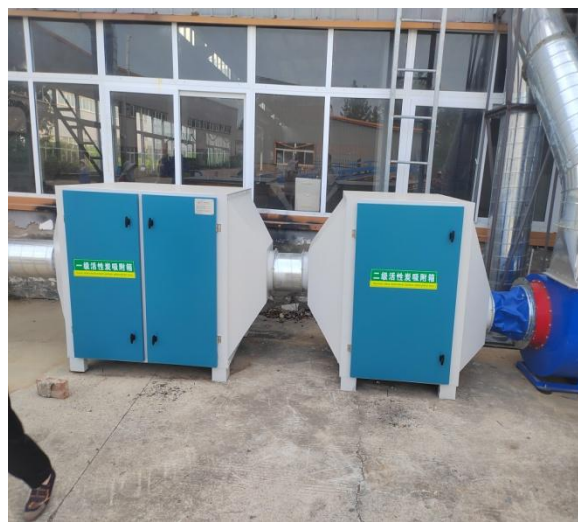
干式过滤器+二级活性炭装置
