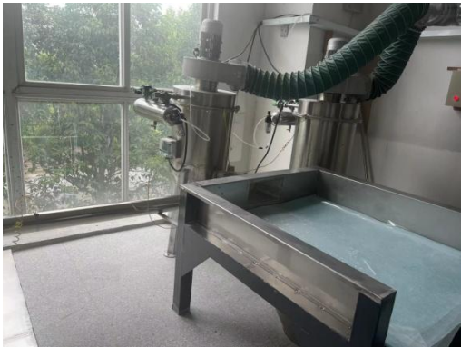
粉尘收集系统+滤筒式除尘器
