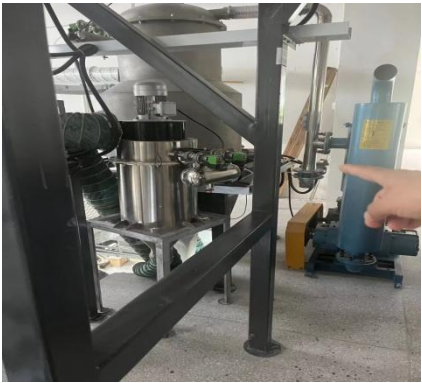
粉尘收集系统+滤筒式除尘器
