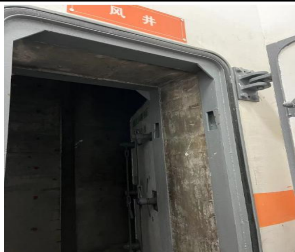
地下车库排风井
