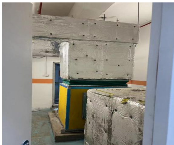
地下车库排风设备
