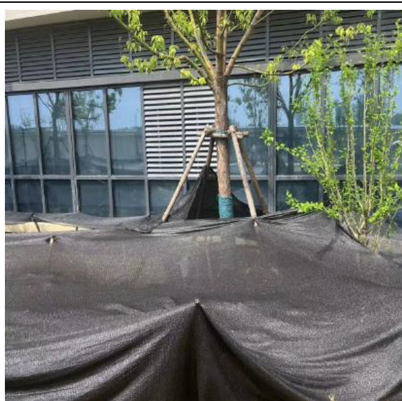
地下车库排风口
