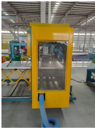
切割工序收尘设施
